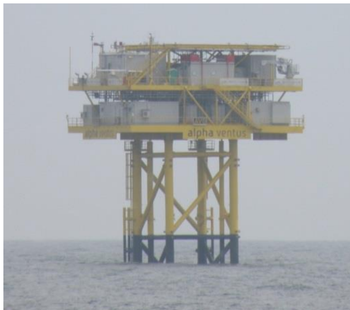
Fotografia 1. Morska stacja elektroenergetyczna
